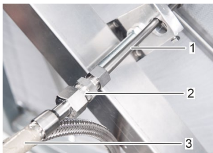
Figura 57: Conexión del suministro de agua a alta presión
